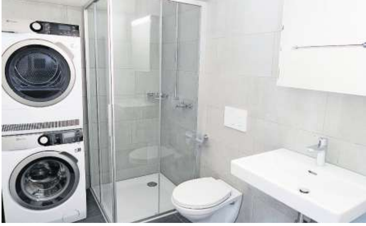
In jeder Wohnung ist eine Waschmaschine und ein Tumbler vorhanden.
